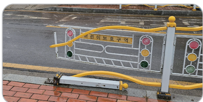
어린이보호구역 안전시설 파손
