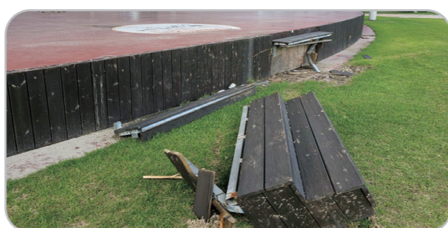
축제장 시설 파손
