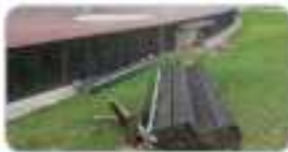
축제장 시설 파손
